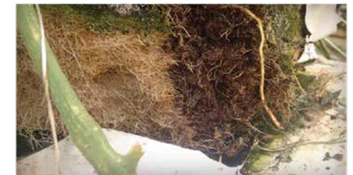
La proliferación de raíces se produce principalmente en la superficie exterior de la losa de cultivo.
